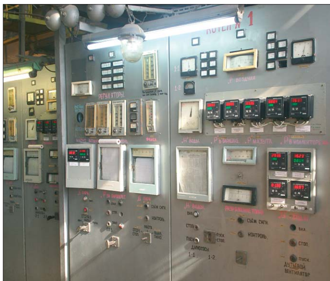
Фото 2. Щит управления паровым котлом №1
